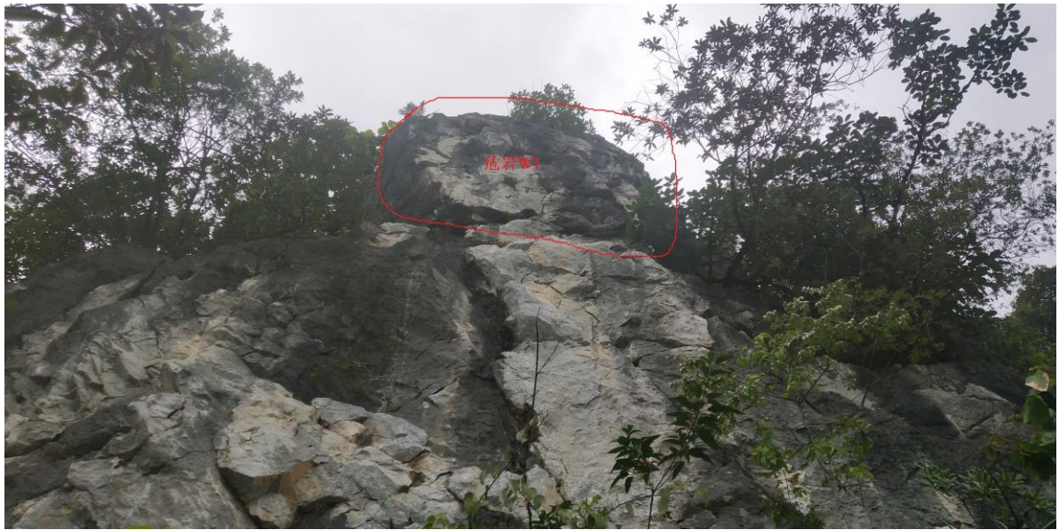
图 3-2-2: 危岩现场照片
